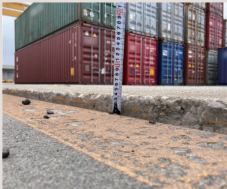
※RTG走行路版の沈下による段差
