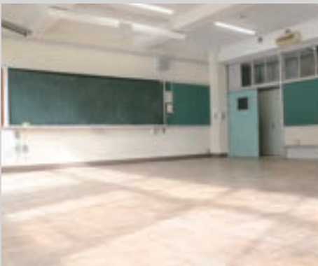
中央部に最大80mmの沈下が生じた教室
